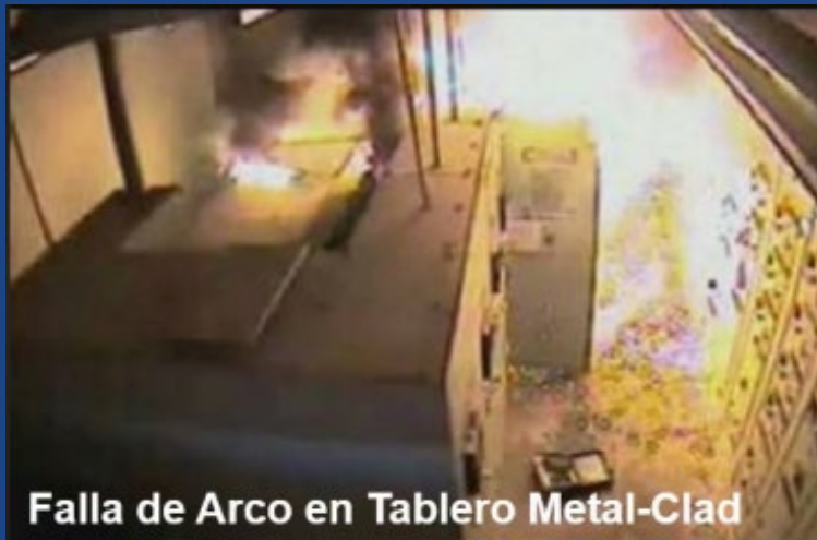
Fig. 1 Foto de una falla con arco eléctrico de tablero de distribución
